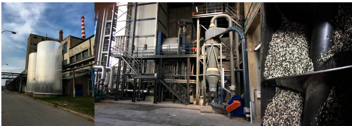
Figure 1. CHP "TE-TO Sremska Mitrovica".
