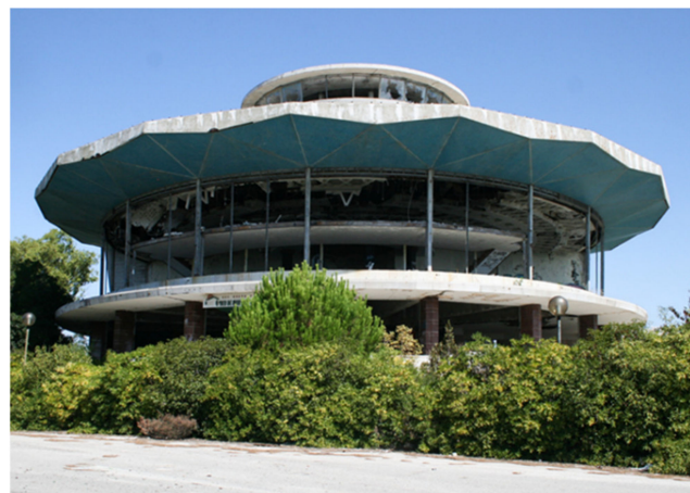
Figure 6. Departamento de Projetos e Equipamentos da CML, Exterior view, 2004 © Impresa Publishing Sa 2018.
