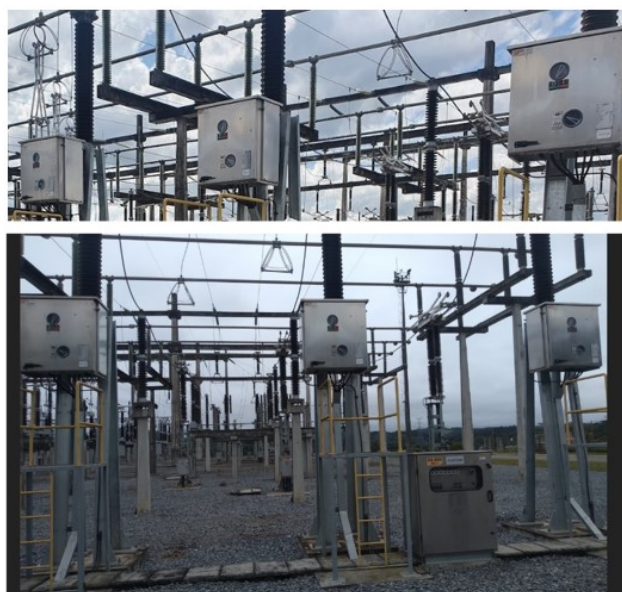
Figure 13. GL 314X circuit breaker, 525/230 kV substation, Copel Geração e Transmissão S.A (Copel Generation and Transmission), Bateias-PR.
