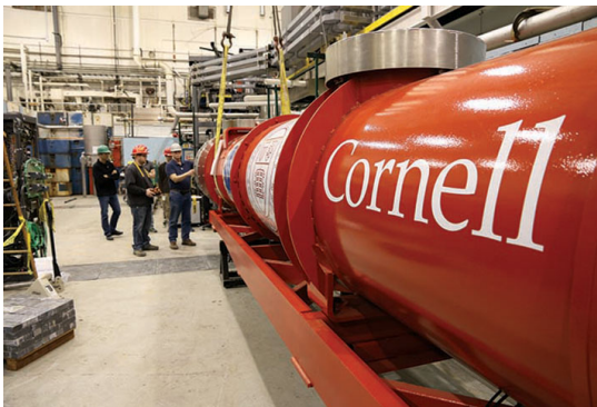
b) The main linac cryomodule.
