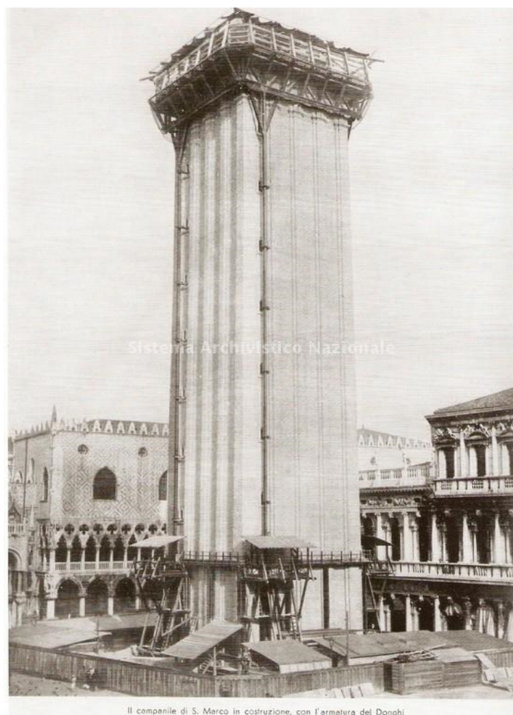
Figure 1. Reconstruction of the San Marco bell tower, Venice ( http://san.beniculturali.it/web/san/dettaglio-oggetto-digitale?pid=san.dl.SAN:IMG-00429727 , Sistema Archivistico Nazionale, December 2021).
